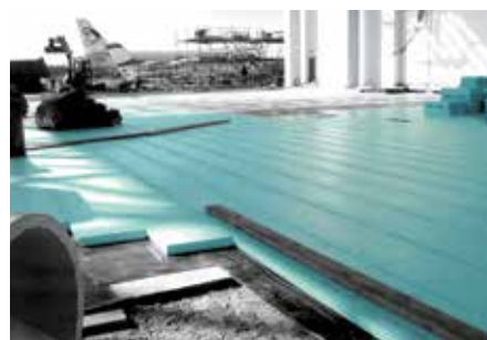
Tepelná ochrana podlahy v hangári s FIBRANxps 700-L.
